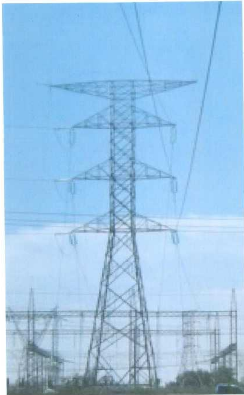
Figura 5.3: Estructura Autosoportada de 2 circuitos E92B21+4 localizada en el tramo de 9km
