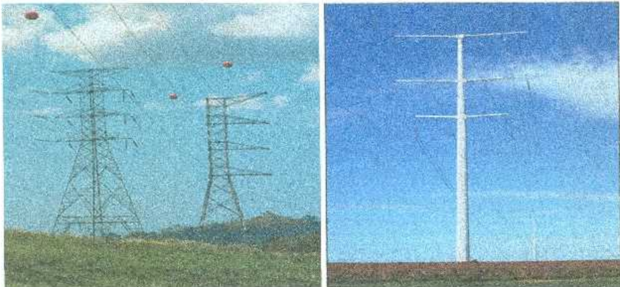
Figura 1.2. Líneas de transmisión de 230 kV.
