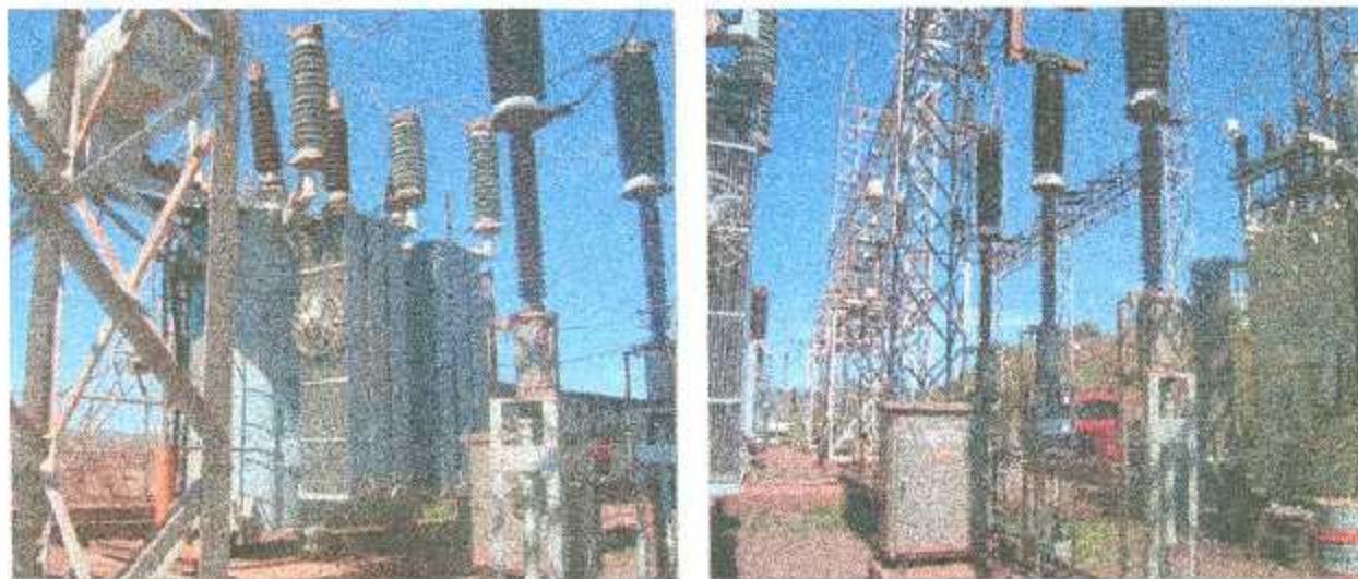
Figura 3.6. Transformadores de 115/13.8 kV, con apartarrayos e interruptores.
