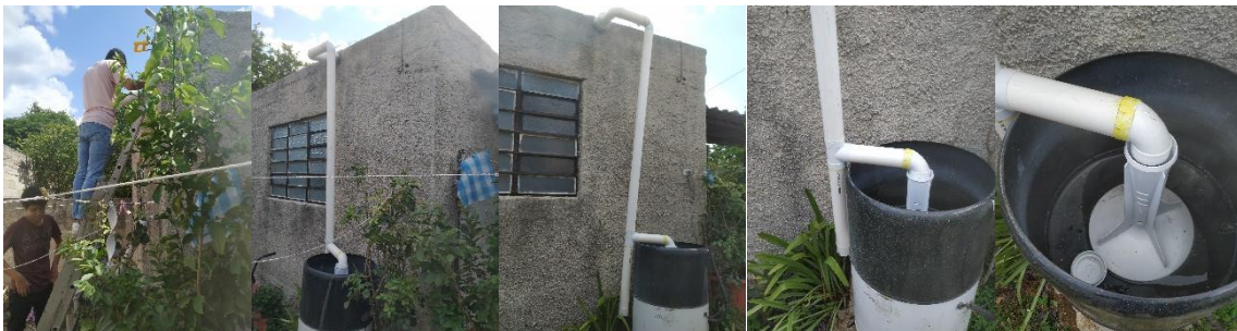
Figura 27. Sistema de captación pluvial
