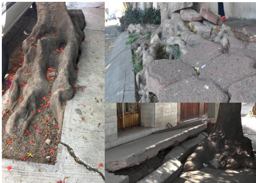
Figura 4. Banquetas dañadas por las raíces de los árboles.
