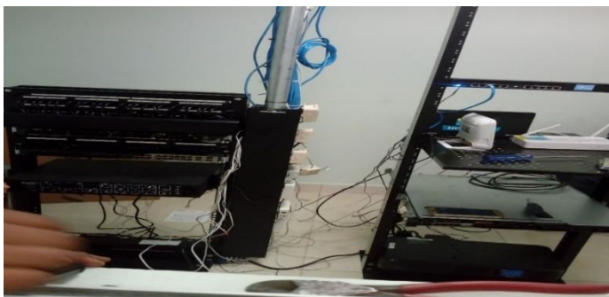
Figura 13. Fotografía del interior en el cuarto de telecomunicaciones denominado rack. Fuente: Elaborado de acuerdo a los requisitos del proyecto
