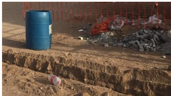
Figura 4. 3 Basura en la entrada de la obra.
