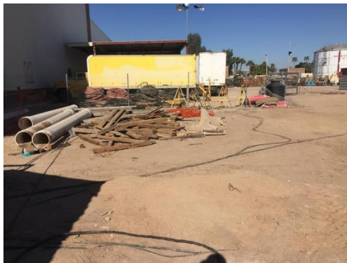
Figura 4. 7 Escombros en el paso de vehículo.
