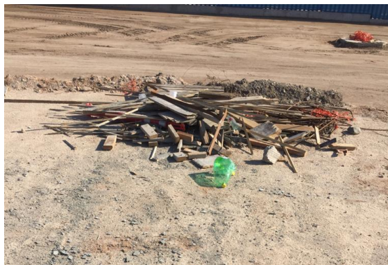
Figura 4. 5 Basura en la zona trasera de la obra.
