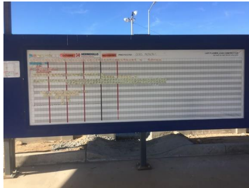
Figura 4. 1 Tablero ubicado en obra.
