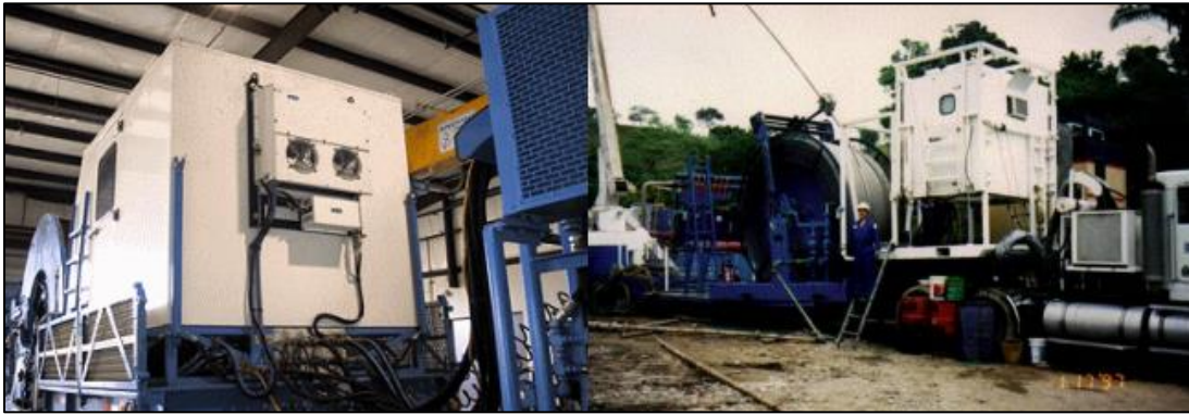
Figura 2.12 Cabina de control.
