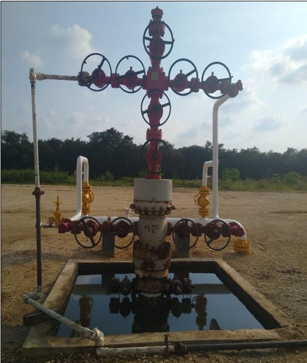
Figura 3.4 Verificar en sitio medio árbol de producción previo a la intervención en el Pozo Mora 25.
