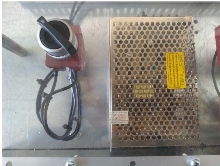
Ilustración 45 Elemento interruptor-selector y fuente de voltaje para PLC.
