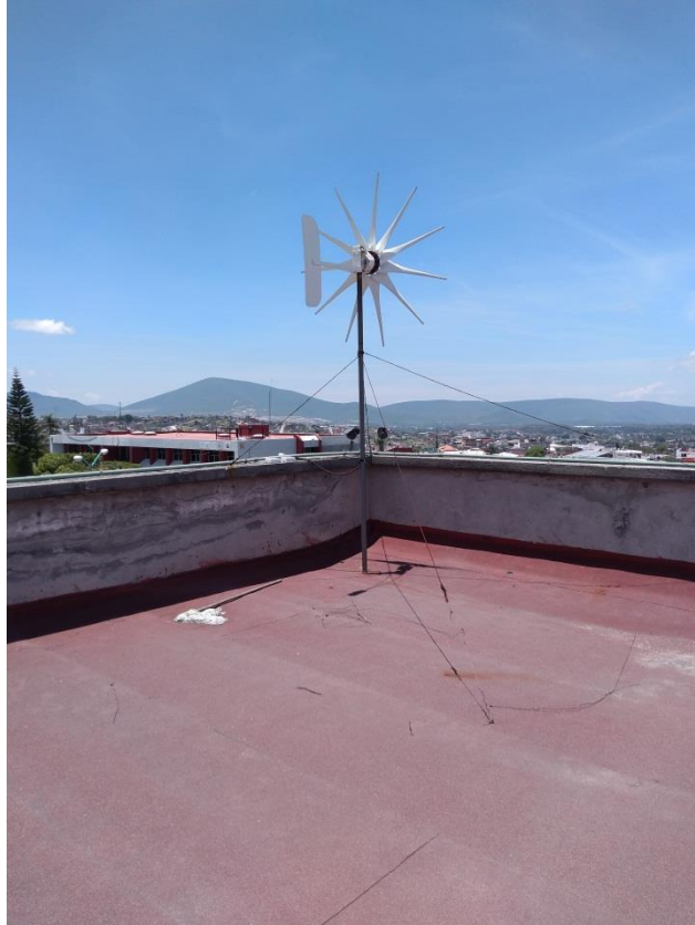
Ilustración 5 Generador de energía eólica.
