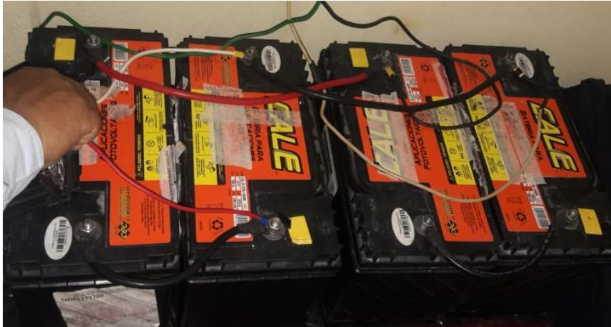
Ilustración 8 Banco de baterías
