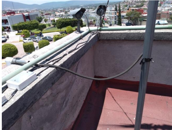
Ilustración 6 Salida de cableado del generador.
