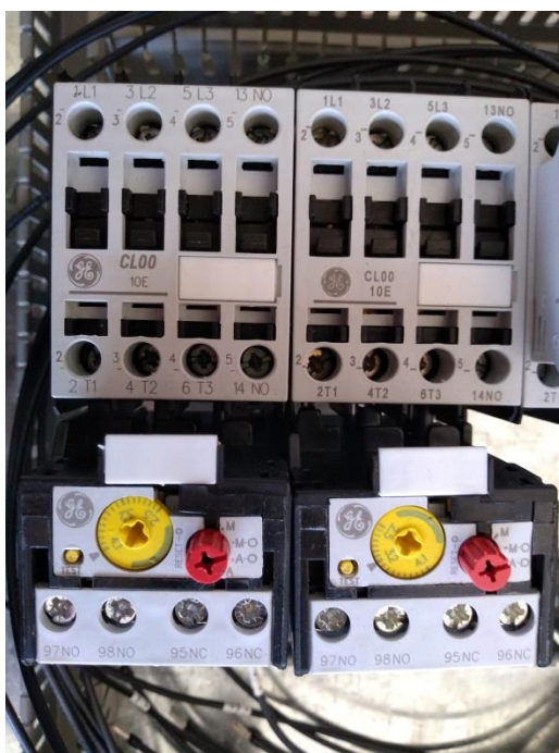
Ilustración 41 Contactores con protección de sobre carga.
