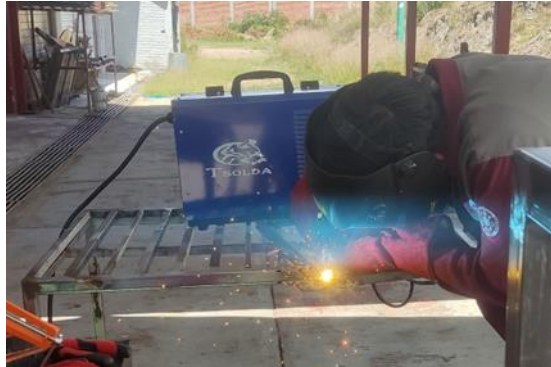
Figura 3.18. Puntos de soldadura en la estructura del cernidor.
