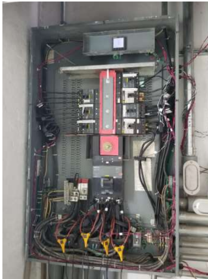
Figura: 15; Conexión correcta del Fluke al gabinete principal
