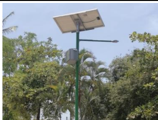
(E.P. # 56) Jardín de las Américas Luminaria fotovoltaica
