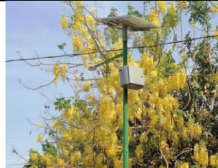
(E.P. # 60) Jardín Colonia Cuauhtémoc Luminaria fotovoltaica
