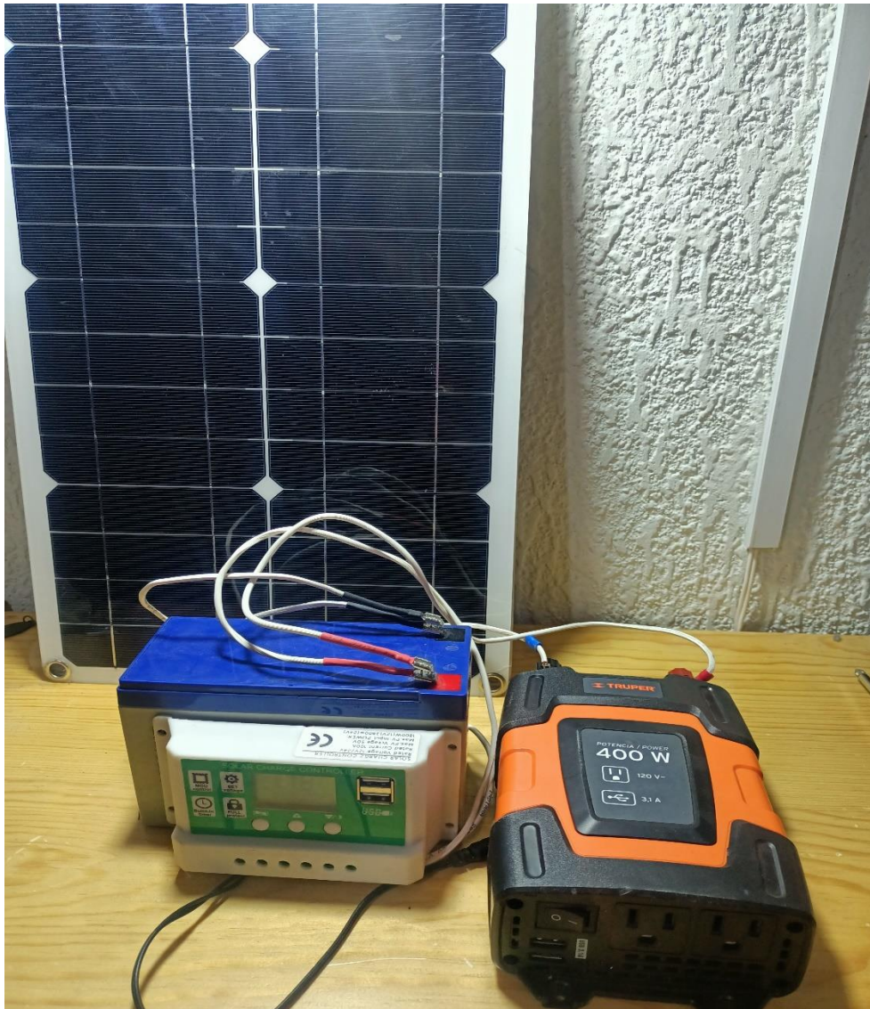
Figura 31.- Sistema Fotovoltaico para abastecer de energía al generador de ozono.
