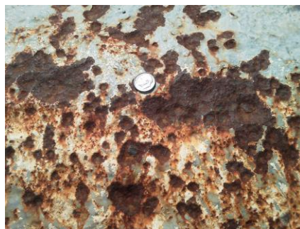
Figura 2. Corrosión por picadura.
