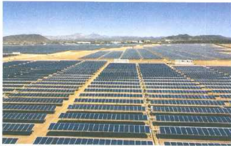
Figura 1.9 : Parque solar fotovoltaico. Tomada de [25].
