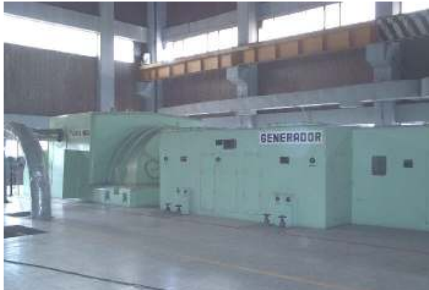
Figura 1.2 Turbogenerador de la Planta Generación Eléctrica
