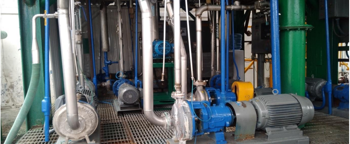
Ilustración 18. Maquina (su sistema de bombeo)
