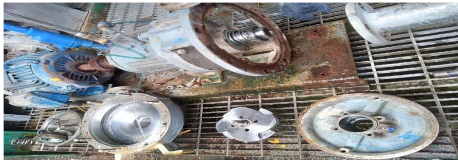
Ilustración 12. Desmontado de centrífuga cambiando arietes, platos, sellos, impulsores y cojinetes fuente: propia.
