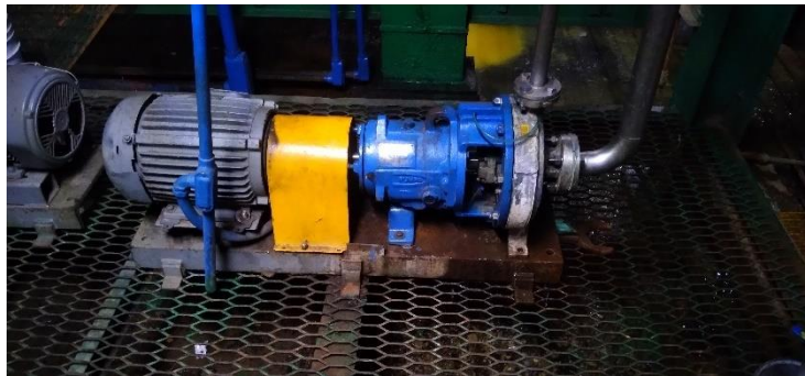
Ilustración 8. Vista frontal de la bomba centrífuga Fuente: propia
