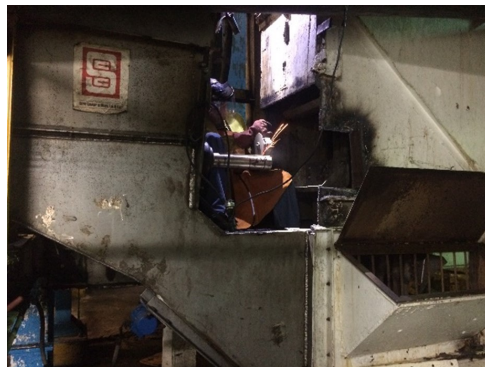
Figura 3-14.: Boca de descarga de transportador de azúcar húmeda al elevador de azúcar húmeda.
