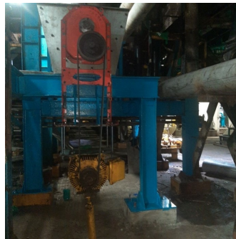
Figura 4-52.: Instalación de transmisión Tipo: Dodge TA6307H15, segunda sección transportador helicoidal.
