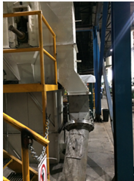
Figura 4-29.: Colocación de tubos de caída de azúcar a secadores.
