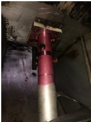
Figura 4-36.: Vista de descarga de Azúcar del transportador al elevador de azúcar.
