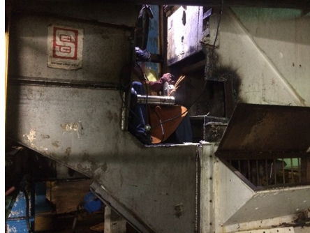
Figura 3-16.: Ubicación de elevador de azúcar húmeda de A, Antes de la modificación.
