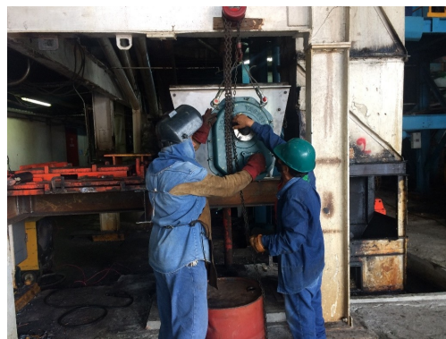
Figura 4-47.: Instalación de transmisión, tipo: Dodge TA6307H15 (Plan A: Opción Original) primera Sección transportador helicoidal.
