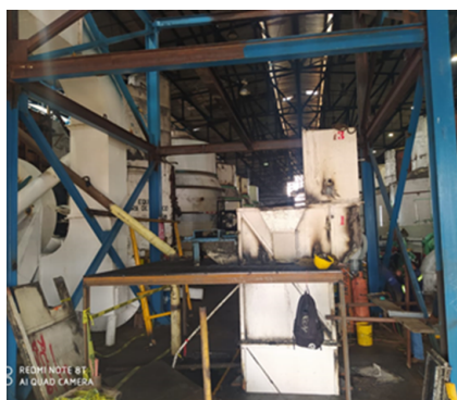
Figura 4-10.: Movimiento de cajones de Elevador de azúcar húmeda en el piso de roto clones.
