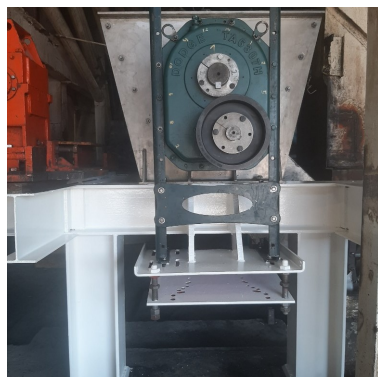
Figura 4-49.: Aplicación de pintura blanca a bastidor de carga primera sección transportador helicoidal.
