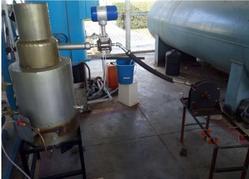
Figura 3. 14 Acoplamiento Caldera - Turbina
