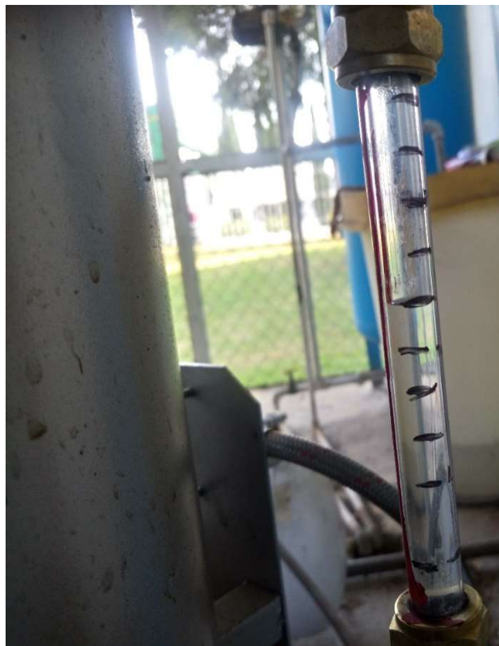
Figura 3. 12 Indicador de Nivel Instalado
