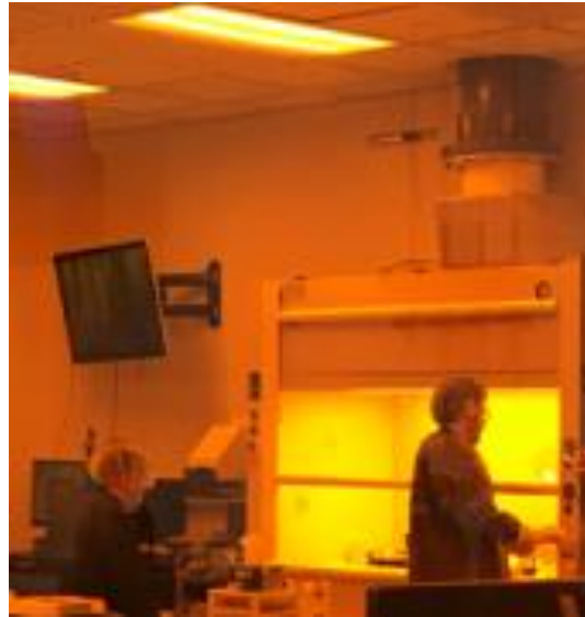
Imagen 15.- Campana de extracción de plástico, utilizada para BHF para la liberación de los dispositivos de la oblea
