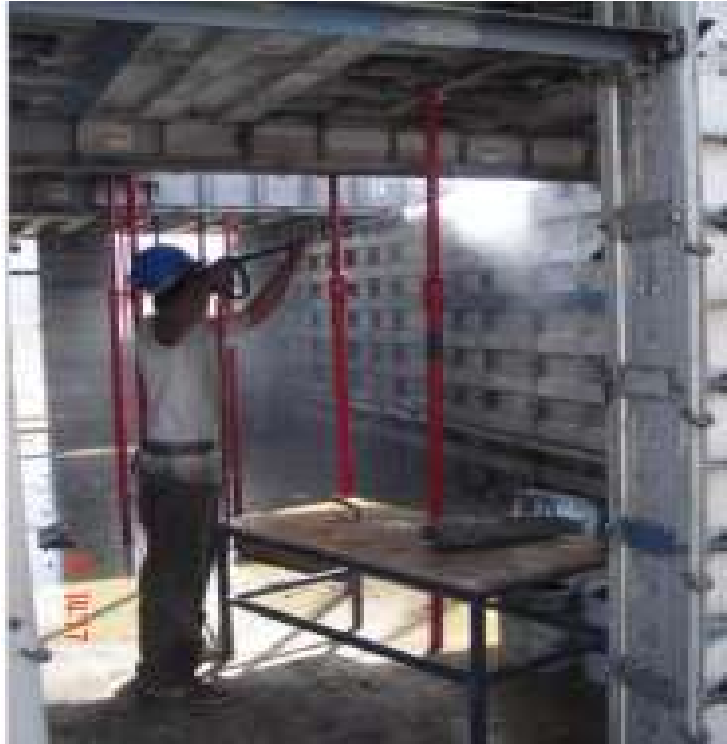
Figura 1421. Limpieza de molde con equipo de hidrolavado. Fuente: Training PDF elaborado por Ing. Jacobo Z.
