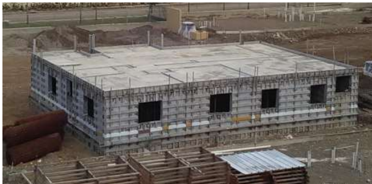
Figura 4. Construcción Monolítica usando formaleta de aluminio. Manual Procedimiento de Obra gris, Western Forms.
