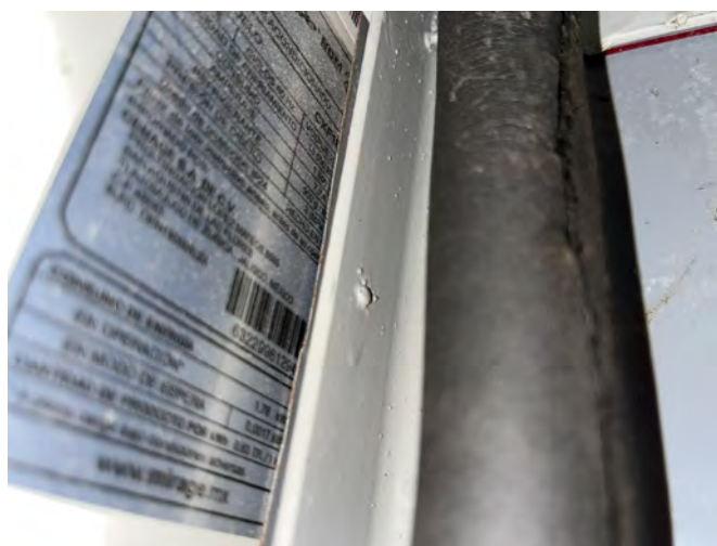
Figura .1: Fotografía de la ficha técnica del chiller .
