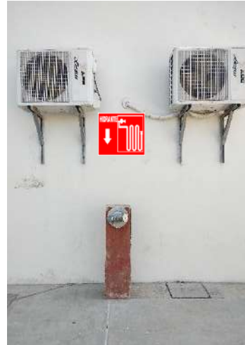
Figura 4.14 Toma siamesa ubicado en el edificio vertical detrás de cafetería
