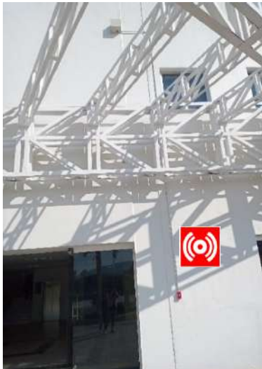
Figura 4.13 Alarma de emergencia en edificio vertical
