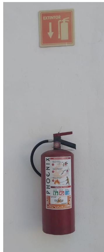
Ilustración 79 EXTINTOR EN PATIO
