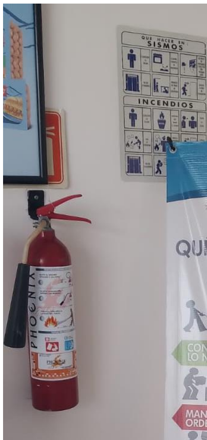
Ilustración 80 EXTINTOR EN RECEPCION
