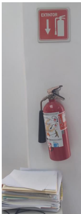
Ilustración 78 EXTINTOR DENTRO DE LA OFICINA
