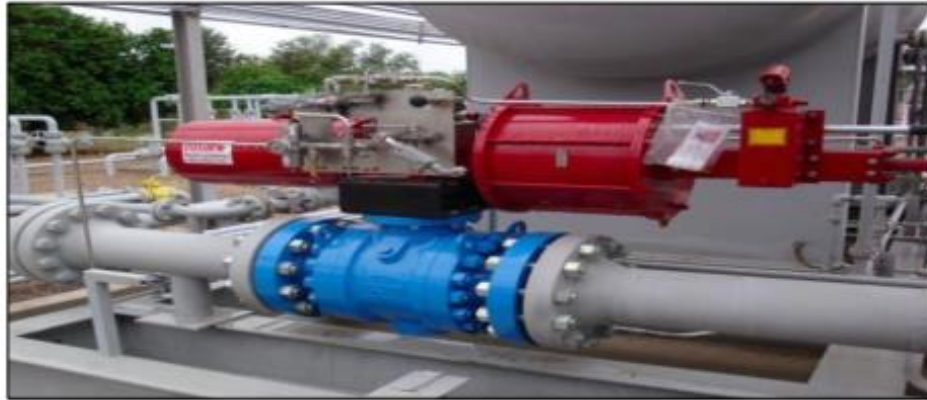
Ilustración 11 CONJUNTO DE VALVULA ESDV AUTOMATIZADA
