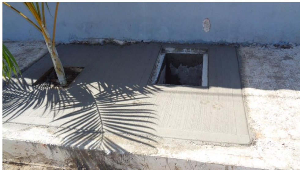
9 Registro principal conectado con su descarga sanitaria.
